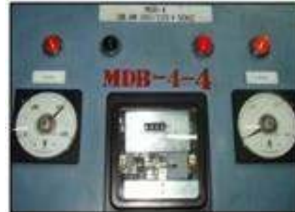
รูปแสดงแรงดันไฟฟ้าที่ MDB-4-4 ก่อนปรับลดแรงดันไฟฟ้า
